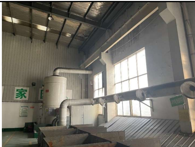
废气应急处理设施：碱喷淋（用于废气应急处置）
